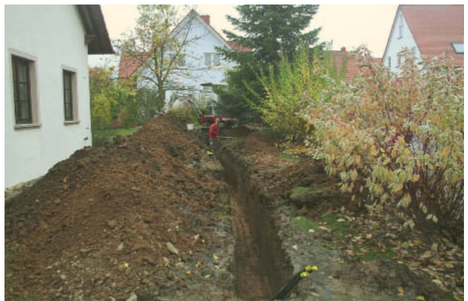
■ Erdwärmesondenfeld bestehend aus drei Erdwärmesonden im Vorgarten.
