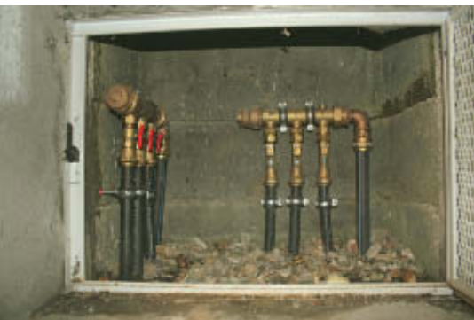
■ Soleverteiler mit Kellerfenster als Revisionsöffnung.
