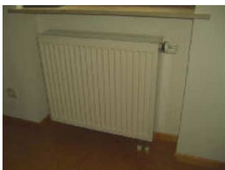
■ Platten-Konvektionsheizkörper im Wohnbereich.
