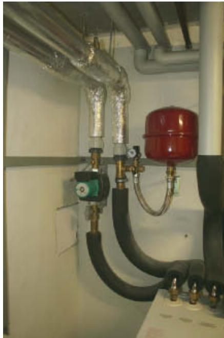
■ Solehydraulik mit Pumpengruppe und (noch nicht abgeschlossener) Rohrleitungsämmung.
