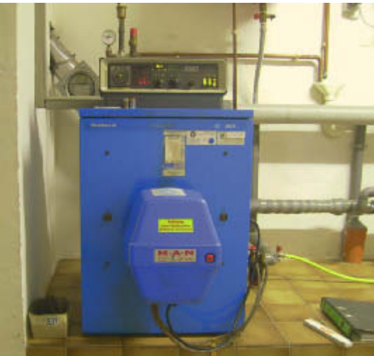
■ Bestehender Heizkessel im Heizkeller.
