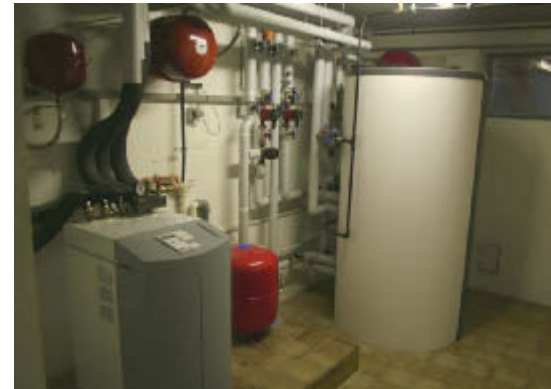
■ Die neuen Komponenten der Heizungsanlage.
