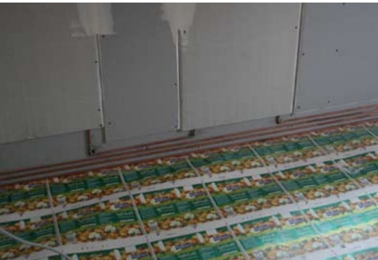
■ Anschlussleitungen für Trockenbau Wandheizungsmodule.
