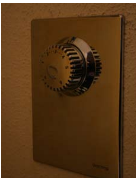
■ Unterputz Thermostatkopf mit Rücklauftemperaturbegrenzer in einer Nasszelle.
