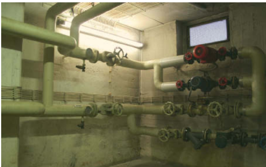
■ Übergabestelle einer Fernheizungsanlage.
