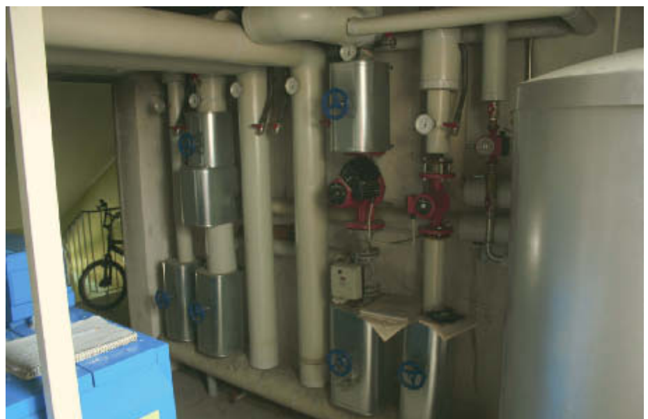
■ Nicht immer werden stufengeregelte Umwälzpumpen durch drehzahlgeregelte ausgetauscht.
