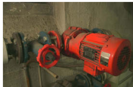
■ Umwälzpumpe einer Fernwärmeübergabestelle.
