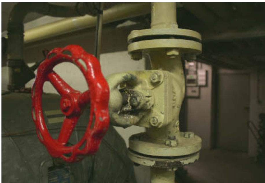
■ Alte Armaturen ohne Wärmedämmung glänzen oft auch mit vielfältigen Ausblühungen.
