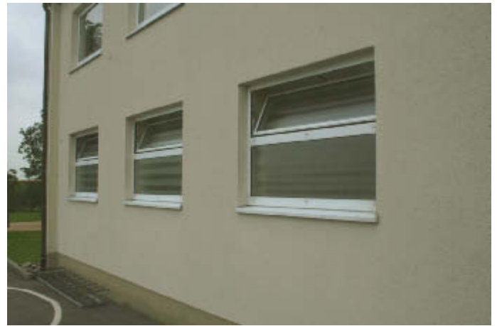
■ Auskühlung des Mauerwerks und Energieverschwendung durch konsequente Dauerlüftung.
